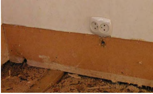
Figur 5: Bilden visar ett likadant vägguttag på motsatt vägg i sovrummet.
