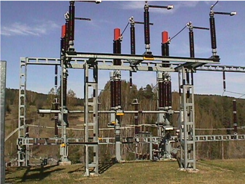
Del av ställverk för högspänning
