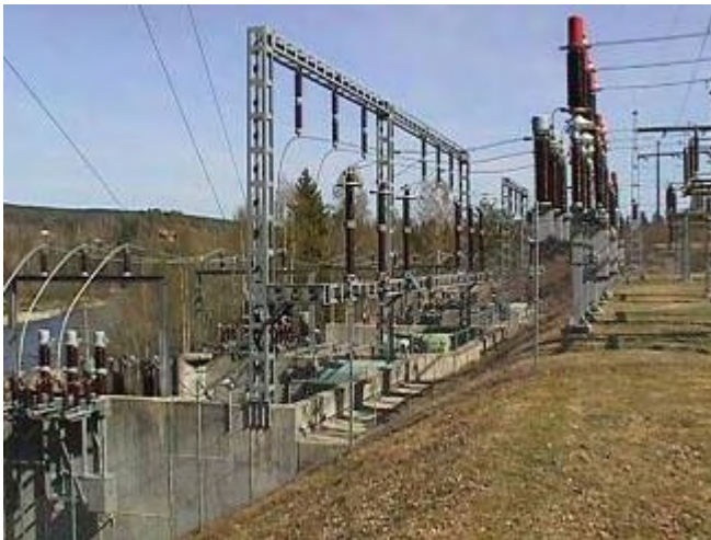
Del av ställverk för högspänning
